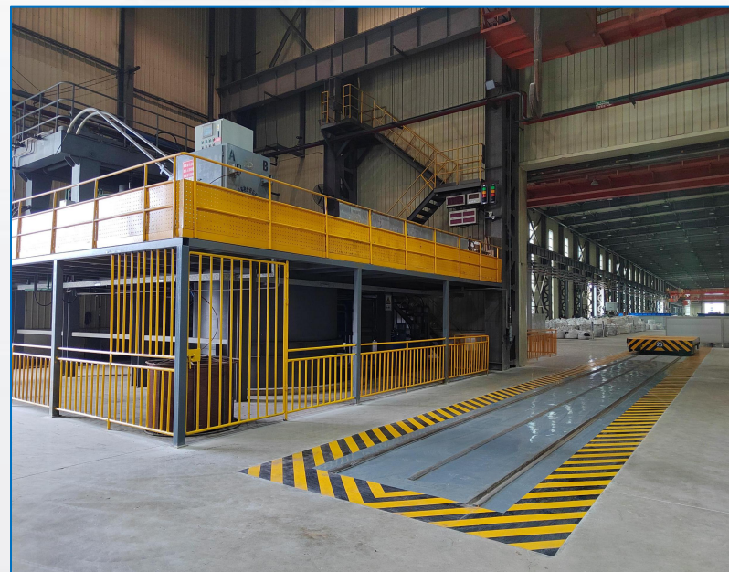
VD炉（真空脱气炉）
